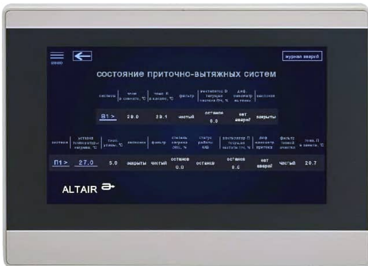
Рисунок 1 – Внешний вид операторской панели
